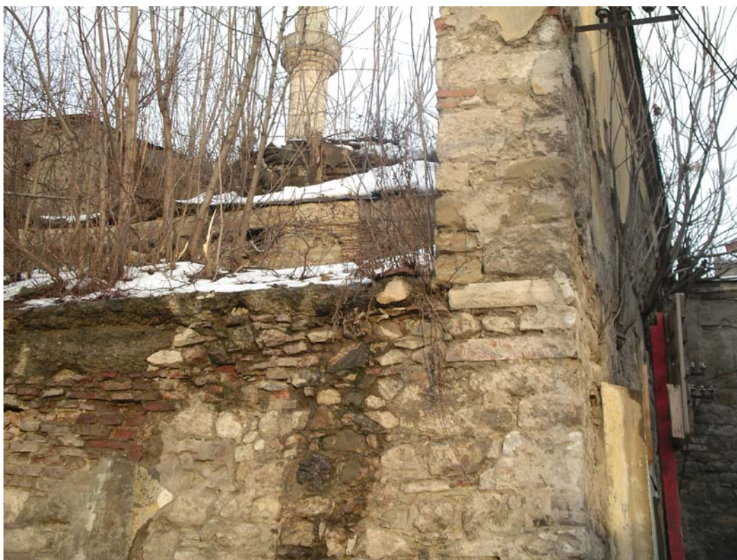
Muri perëndimor i Hamamit të madh – drunjtë e rrënjosur në mur ilustrjnë moskujdesin shumë-vjeçar.
